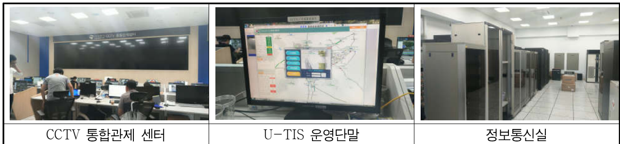
<그림 4-66> 의정부시 CCTV 통합관제 센터 현황
